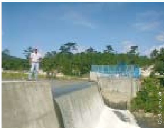
Wasserkraftwerk: Überlauf am Staubecken
