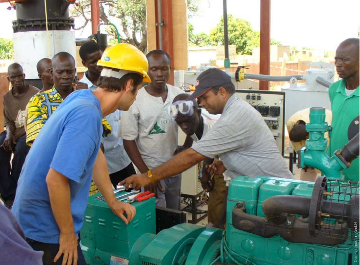
Inbetriebnahme des Gasmotors zur Stromerzeugung aus (Baumwoll-) Ernteresten für ein Krankenhaus in Burkina Faso
