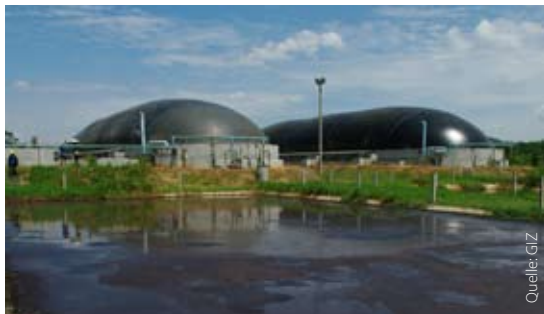
Thailand: Biogas plant
