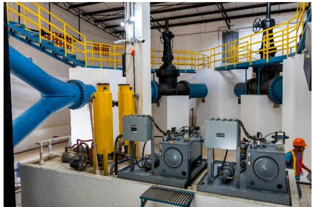
Maschinen im Inneren des Wasserkraftwerkes
