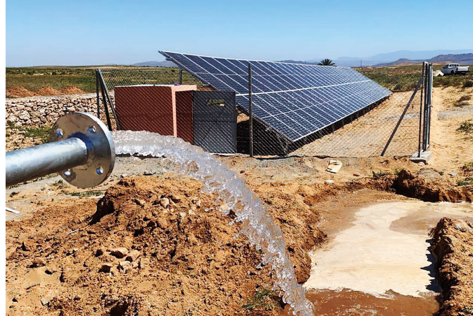
Die Wasserpumpen werden komplett mit Solarenergie betrieben
